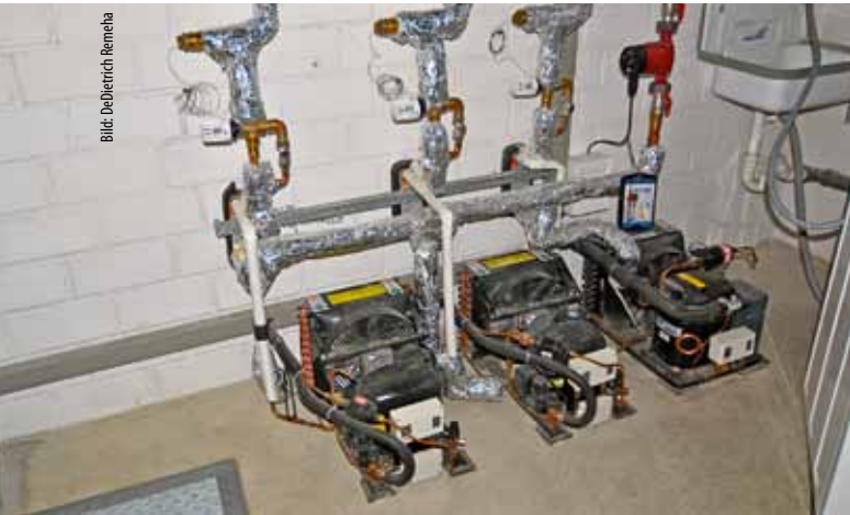
4 Wärmerückgewinnung: Die Abwärme der Kälteerzeugung für den Kühlraum der Kantinenküche wird in einem Pufferspeicher für die Trinkwassererwärmung der Küche gesammelt.
